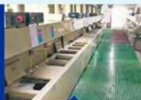
电镀设备-电镀车间一角
